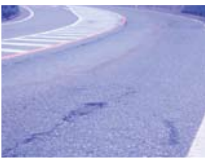
老朽化した舗装道路
